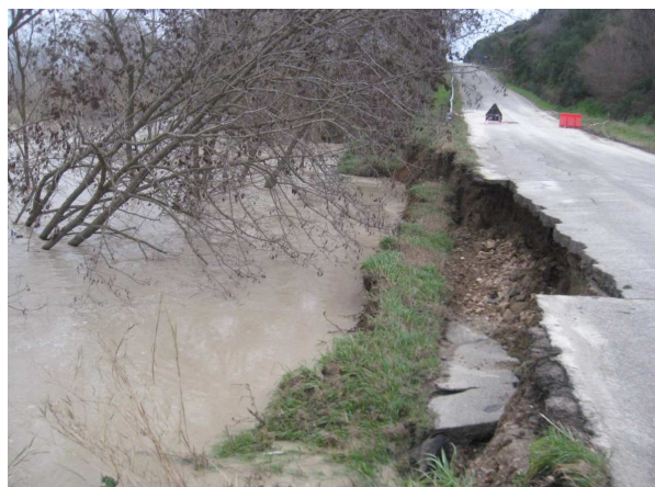
Pisticci – Località Gallotta erosione del rilevato della strada provinciale marzo 2011
